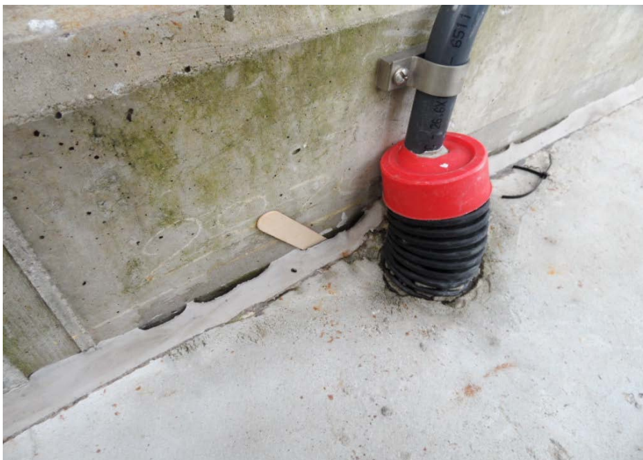
Foto: Gebrek in een afdichting.
